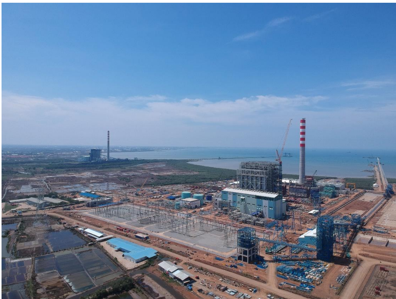
写真：稼働中のチレボン石炭火力発電所1号機（奥）と建設中の2号機。（インドネシア環境フォーラム・西ジャワ。2020年10月）
